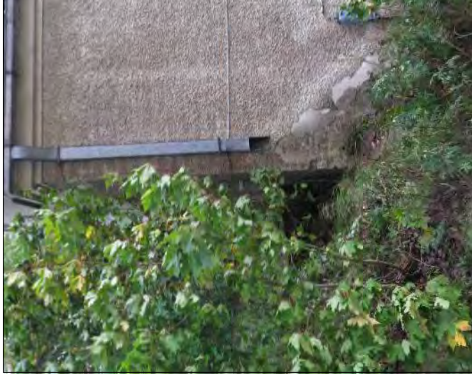
Syöksytorvet ovat liian lyhyet ja rännit ovat ruostuneet osittain puhki. Kuva Liisa Nummelin, syyskuu 2018.
