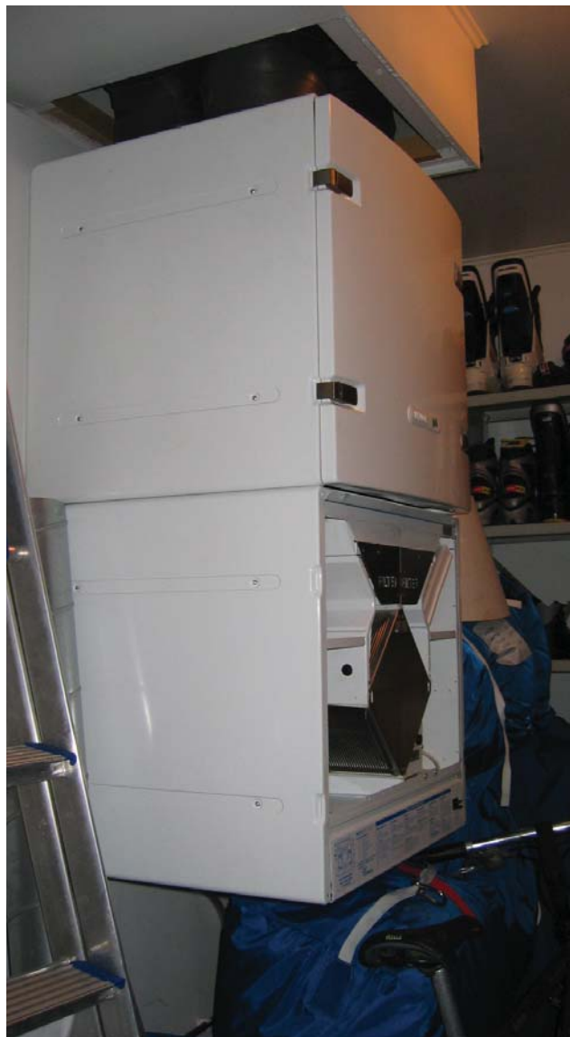
Kuvassa pyörävarastoon asennettu tulo- ja poistoilmanvaihtolaite, jonka lämmöntalteenotto tapahtuu alaosan ristivirtauskuutiassa.
