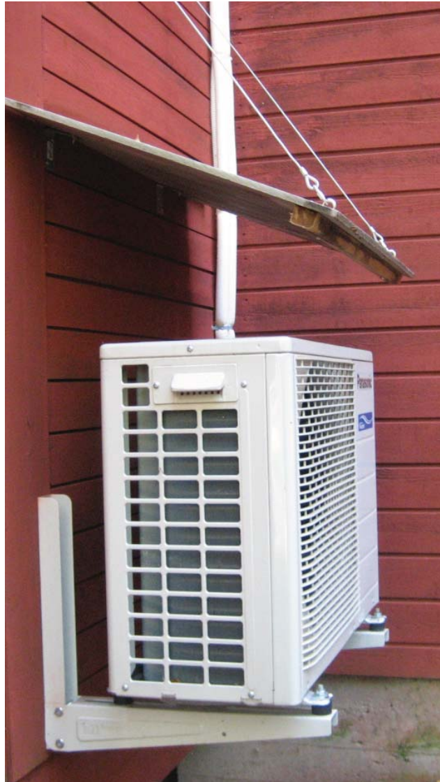
Kuvassa asuinrakennuksen ulkoseinään kiinnitetty ilmalämpöpumppu.
