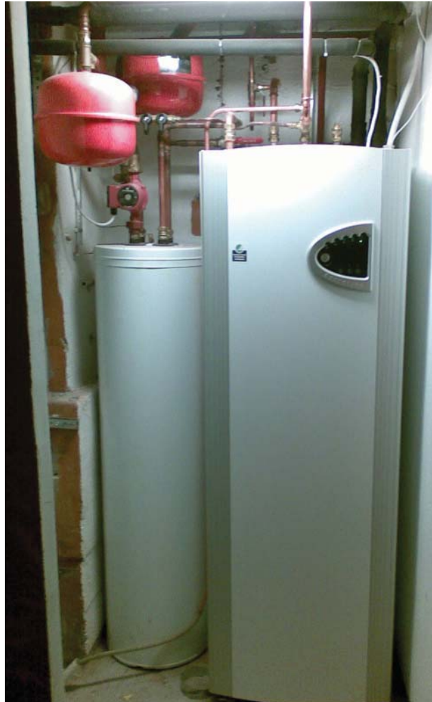
Kuvassa asuinrakennuksen kellariin sijoitettu lämpöpumpun kompressor, joka on korkean jääkaapin kokoinen. Lämmönkeruuputkisto on tässä talossa asennettu 190 metriä syvään pora-reikään.
