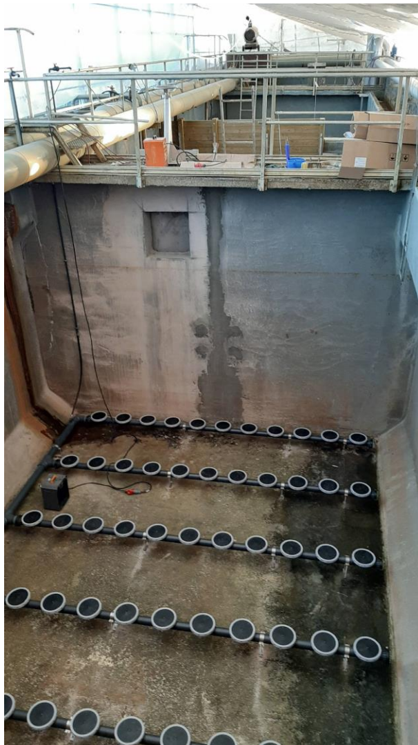
Kuva: Uudet pohjailmastimet asennettuna ilmastusalttaaseen.
